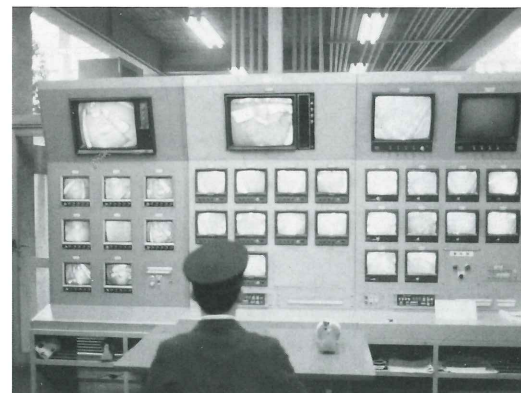
文化財の公開、保存にあたっては、防犯設備として監視カメラなどの警戒システムもとられています（写真は、展示室の動きが一目でわかるテレビ受像設備）
