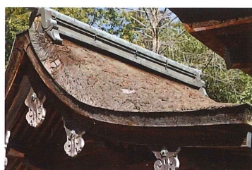
賀茂別雷神社(上賀茂神社・京都市北区)奈良社本殿修理工事 寛永5年(1628)造替の記録が残る、屋根檜皮葺の損傷やアライグマによる被害などの損傷が著しいことから修理工事が行われる。
